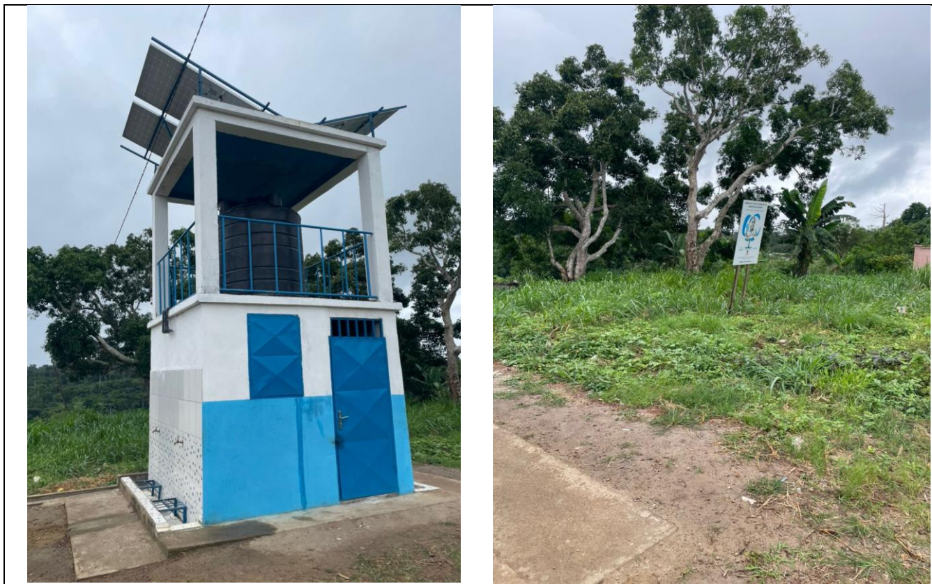
Forage existant sur le site
